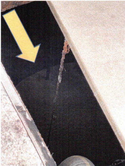
Foto 07 – Nível do poço da EEE Parque dos Sinos sendo mantido bem abaixo do limite de extravasamento em 10/05/2022.
