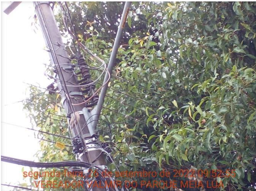
Fotos 7, 8 e 9: Av. Azênio de Azevedo Chaves, em frente ao nº 752, no Prolongamento do Jardim Santa Maria
