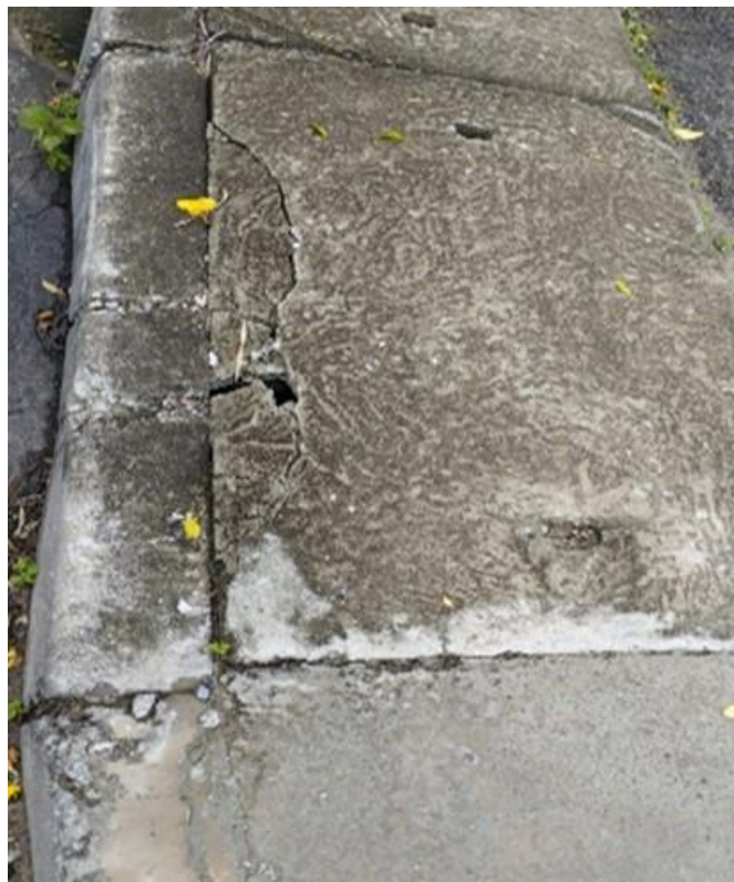
Foto 2: Rua Dom João II, defronte ao nº 505, no Parque dos Príncipes
