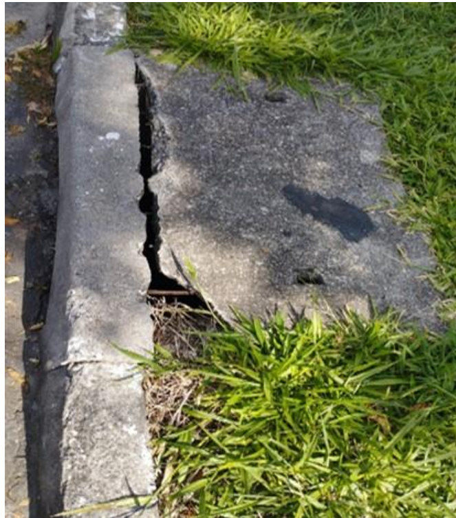
Foto 1: Avenida Suzana de Castro Ramos, defronte ao nº 421, no Jardim do Vale
