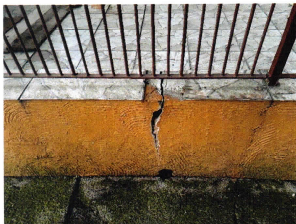
Foto 2. Vista do dano na mureta, próximo à árvore na calçada.
