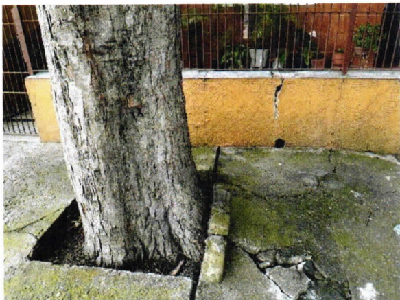
Foto 1. Vista da base da árvore, e mureta com dano pronunciado próximo ao exemplar.
