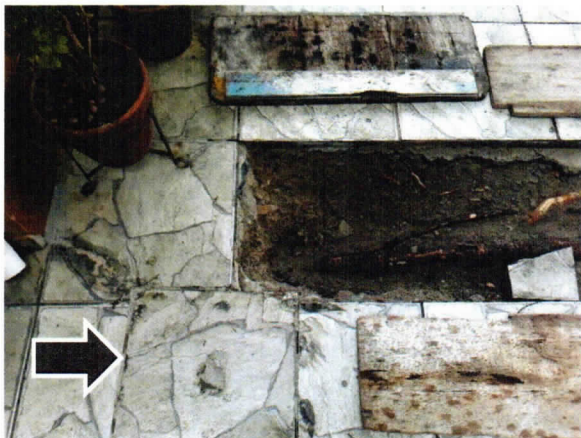
Foto 7. Vista de raiz da Sibipiruna se aprofundando em direção à residência. A seta aponta localização de caixa de passagem de esgoto.
