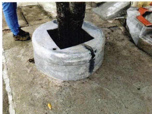
Foto 3. Vista do calçamento ao redor, sem danos. Estrutura ao redor da árvore diminui área de passagem.
