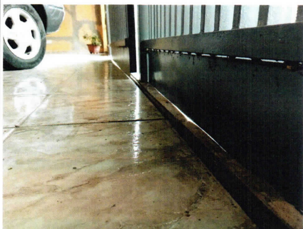
Foto 13. Desnivelamento da folha fixa do portão deslizante.
