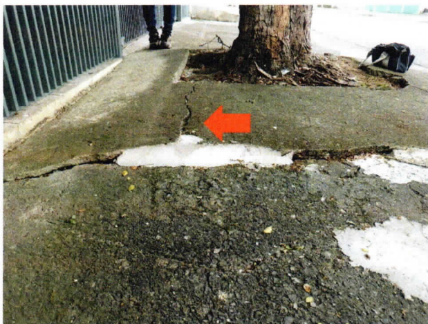
Foto 9. Levantamento de placa de concreto próxima à folha fixa do portão deslizante.
