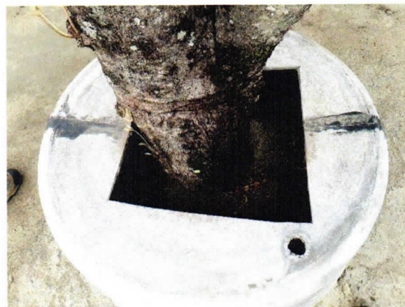
Foto 4. Vista do colo do exemplar, com acúmulo de resíduos de varrição dentro da estrutura instalada ao redor da árvore.
