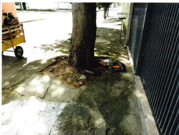
Foto 5. Trincas e rachaduras na calçada.
