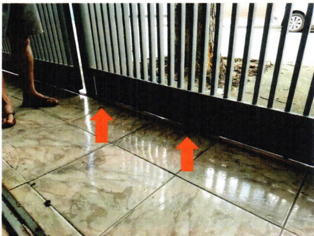
Foto 11. Base do portão fixo encostada no piso de concreto da calçada.
