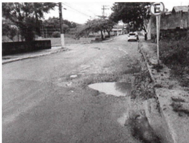
Foto 9: Rua Eng. Flávio da Silva Freitas, em frente ao número 927, no Bairro Chácaras Reunidas Ygarapés
