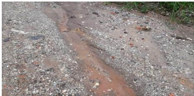
Fotos 3 e 4: Buracos no leito carroçável decorrentes de erosão
