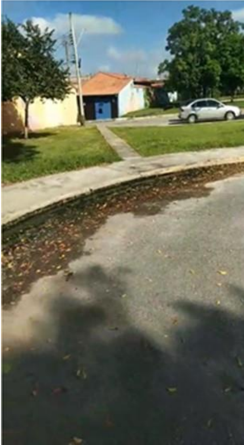
Foto 1: Boca de lobo obstruída
