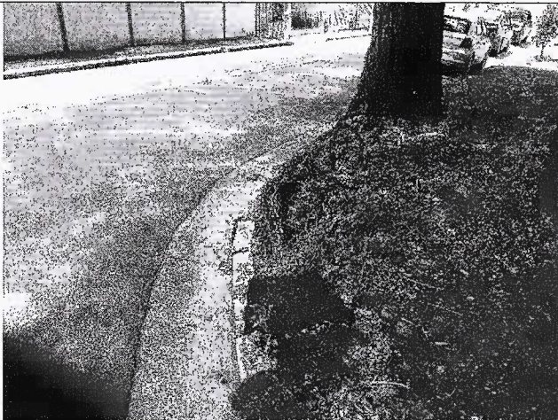
Foto 3. Área livre para passagem de pedestres com pisos quebrados e raízes afloradas.
