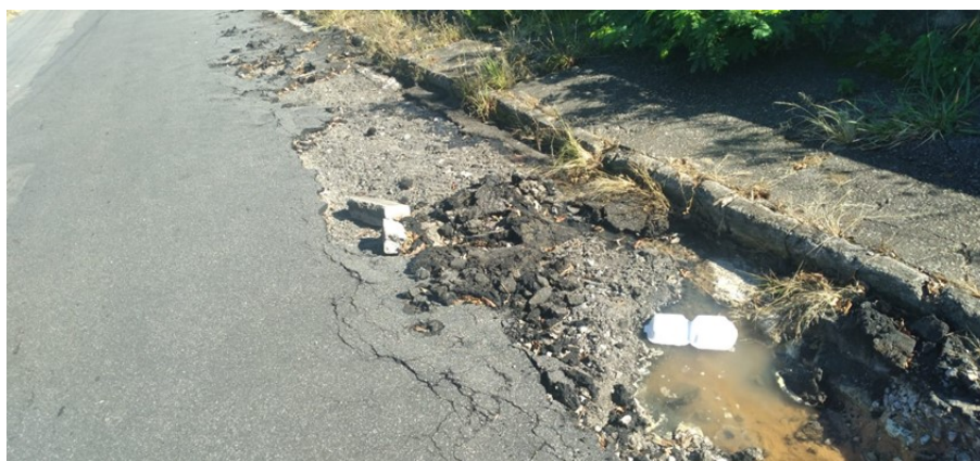
Foto 2: Avenida Alfredo de Macedo (asfalto está cedendo e abrindo um grande buraco)
