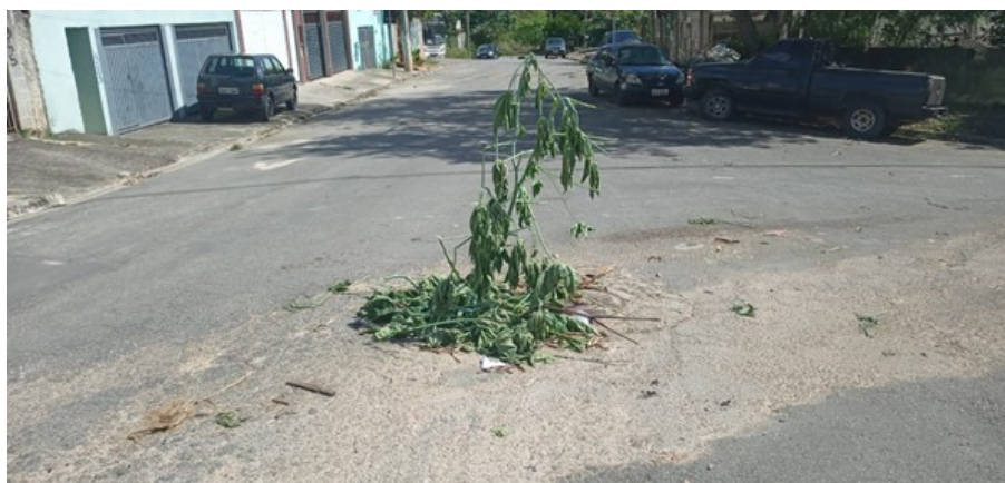
Foto 1: Defronte do nº 361 da Avenida Profª Beatriz Junqueira da Silveira Santos
