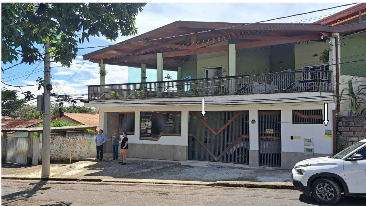
FOTO 02 - FIO SOLTO A MEIA ALTURA
