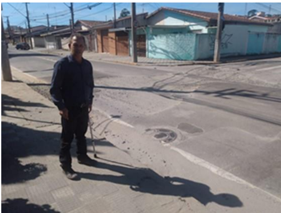
Foto 2: Defronte do nº 402 da Rua Anésia Ruston, no Jardim das Indústrias.
