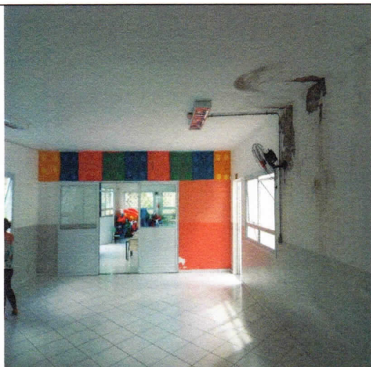
Foto 05 – Vista geral da área comum onde nota-se infiltrações e sinais de umidade na laje de forro;
