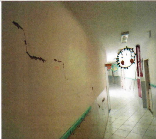
Foto 02 – Vista de um dos corredores internos onde nota-se trincas e rachaduras nas paredes;
