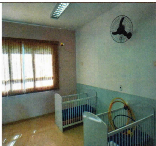
Foto 03 – Vista do interior do berçário onde notamos surgimento de trincas
