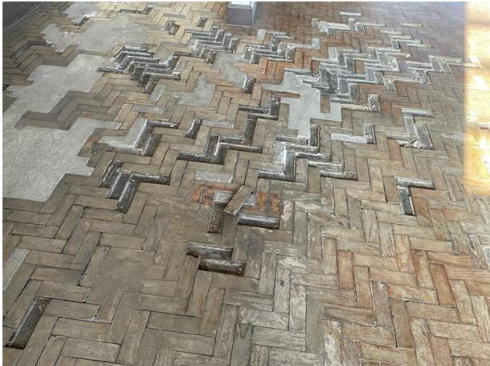
FOTO 2 - Piso com tacos de madeira danificados
