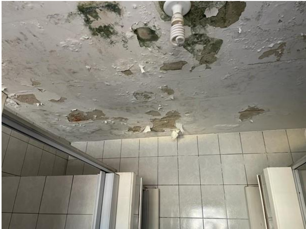
FOTO 4 - Banheiro interditado em razão de infiltrações
