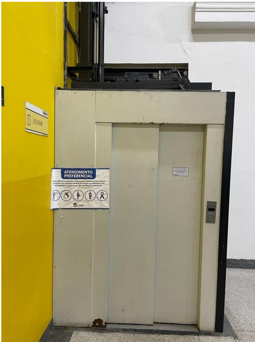
FOTO 1 - Elevador sem funcionamento
