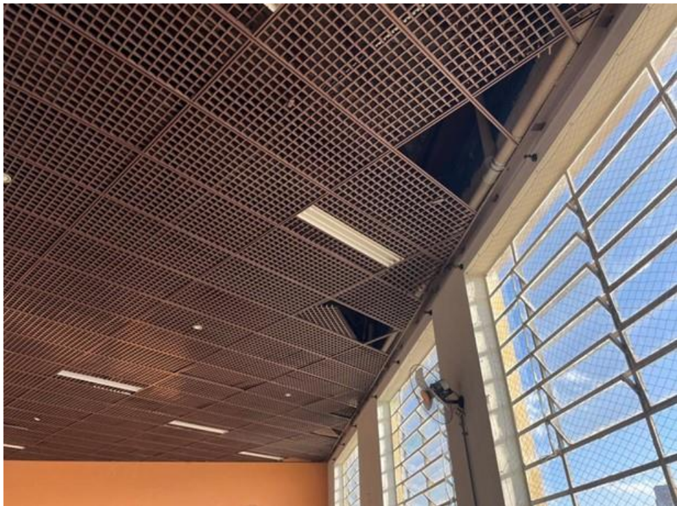
FOTO 3 - Forro do teto em más condições
