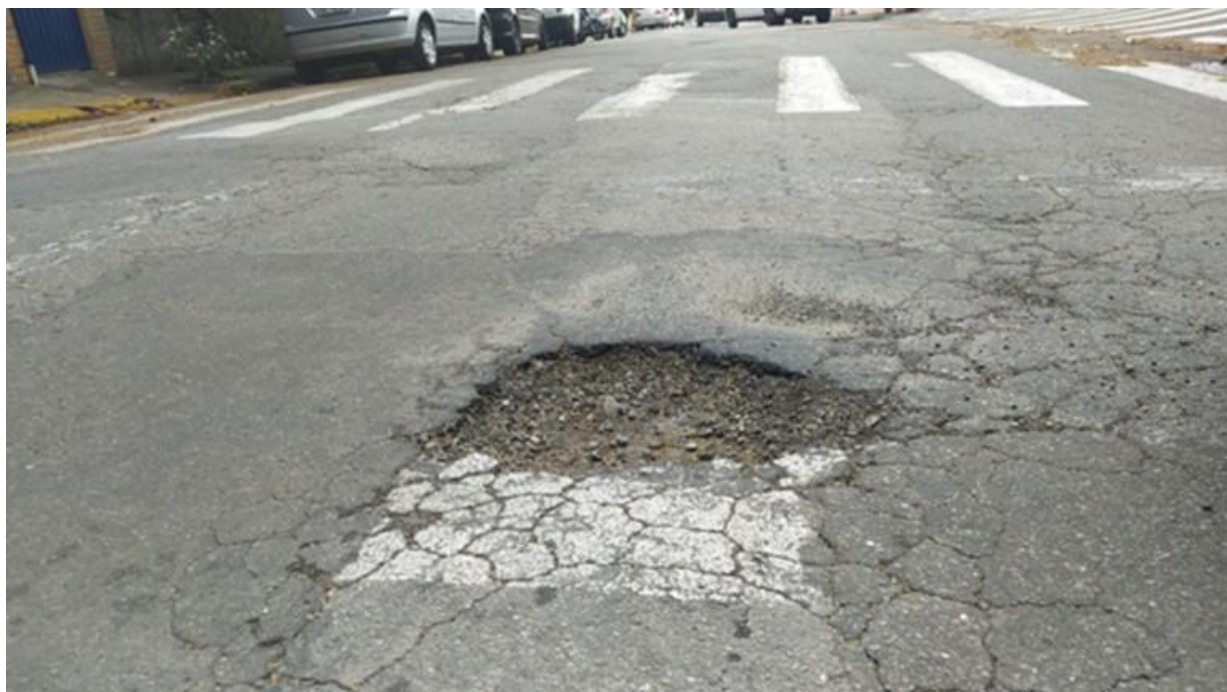
Foto 2: Rua Ernesto Duarte, próximo ao nº 70, no Parque Califórnia
