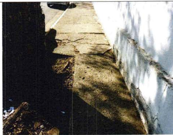
Foto 20. É possível a reforma do calçamento.
