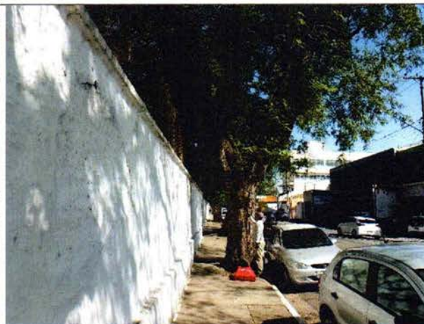
Foto 24. Há danos leves na calçada.
