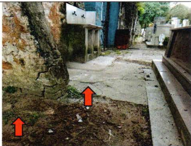
Foto 39. Há raiz aflorada e uma trinca no piso na área interna do cemitério.
