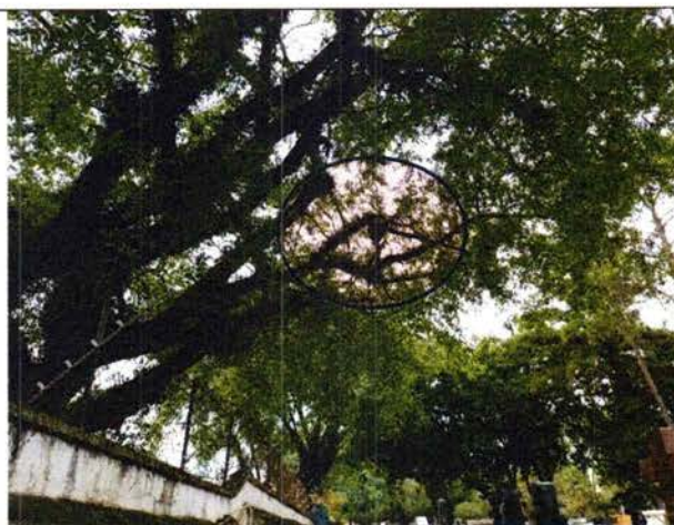
Foto 44. Na copa há galhos quebrados pendurados sobre a área do cemitério.
