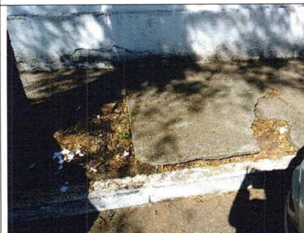
Foto 19. Há raízes expostas com ausência do piso em alguns pontos.
