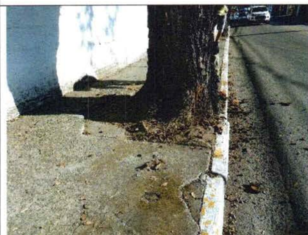
Foto 43. Danos leves na calçada.
