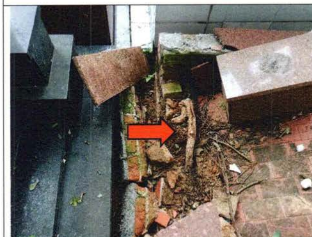
Foto 35. Afloramento da raiz na parte interna do jazigo.
