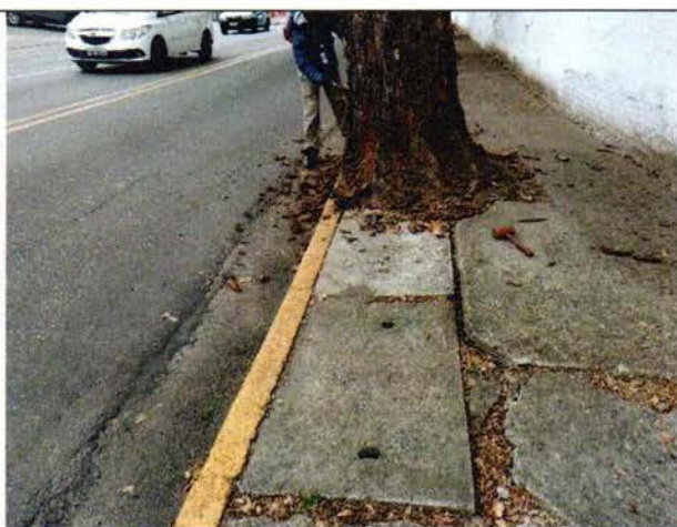
Foto 56. Calçada com danos leves.
