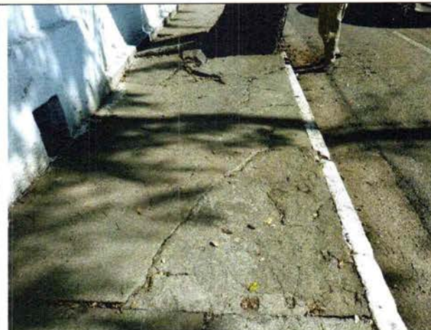
Foto 28. Danos leves na calçada.
