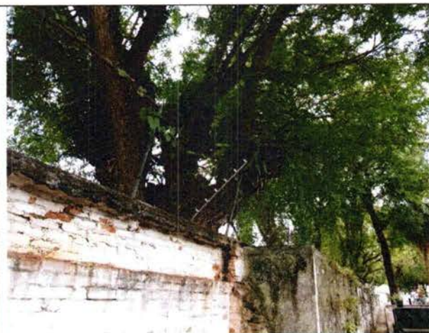
Foto 36. Grade afixada no muro de divisa do cemitério pressionada por galho primário já podado. Há trincas no muro.
