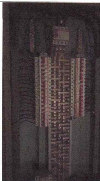
CORREDOR QUADRO GERAL REAPERTADO
