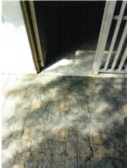
Foto 5. Vista da trinca na calçada e sob portão social.
