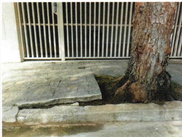
Foto 3. Vista do deslocamento do piso adjacente ao canteiro.
