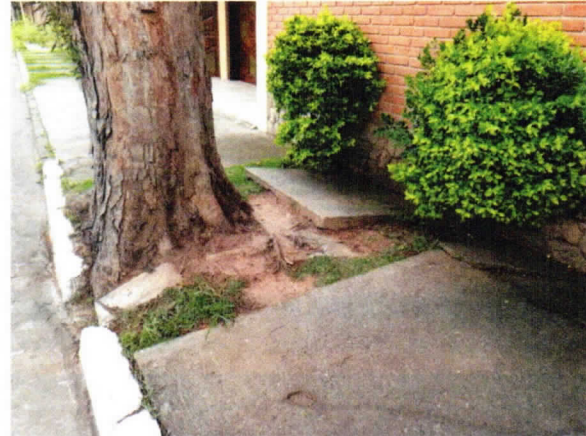
Foto 2. Placas de concreto levantadas pelas raízes da árvore.
