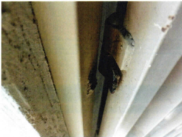
Foto 7. Vista de parte do portão, rompida, em razão de seu levantamento.
