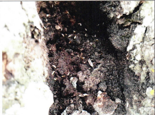
Foto 4. Detalhe da cavidade infestada por cupim.
