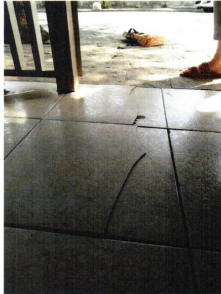
Foto 6. Vista de pisos trincados e levantados, sob portão social (dificuldade de uso dessa estrutura)
