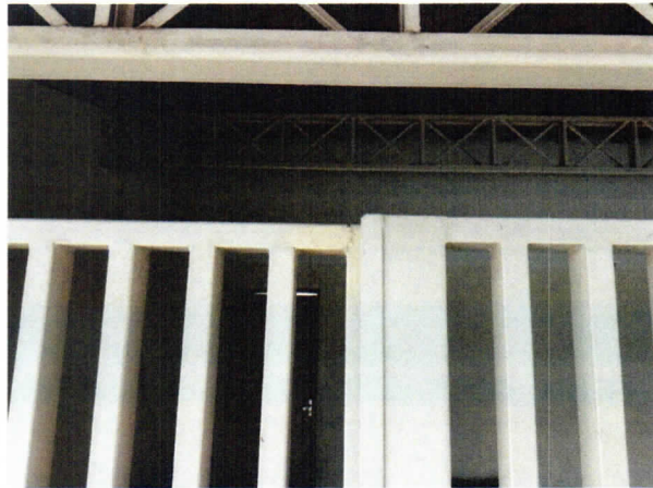
Foto 8. Vista da diferença entre as folhas de portão móvel (esquerda) e fixa (direita), com desnível de aproximadamente 2,5 cm
