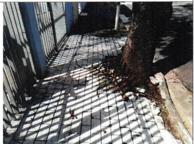
Foto 8. Danos leves na calçada.
