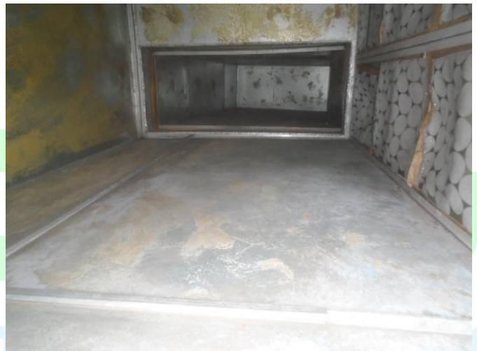
DUTO PÓS-LIMPEZA (Foto 10)
