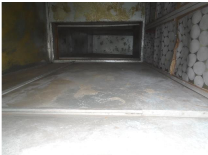
DUTO ANTES DA LIMPEZA (Foto 05)
