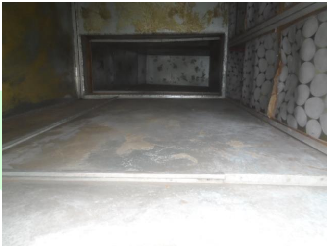
DUTO ANTES DA LIMPEZA (Foto 09)
