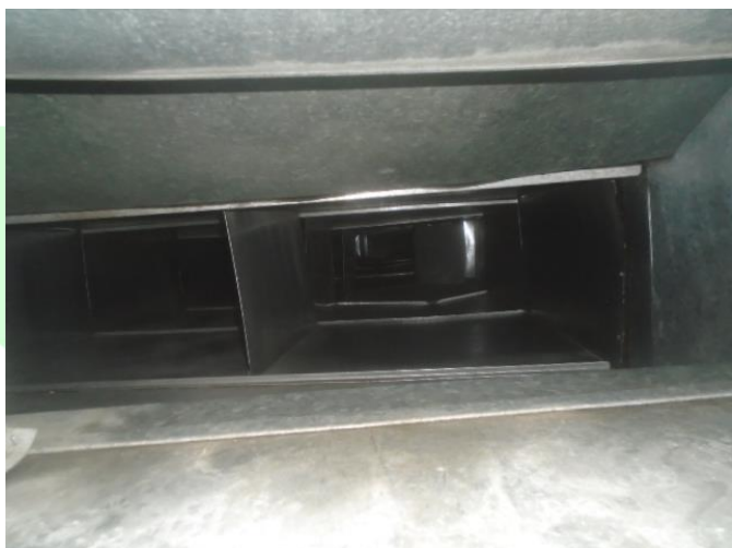
DUTO ANTES DA LIMPEZA (Foto 03)
