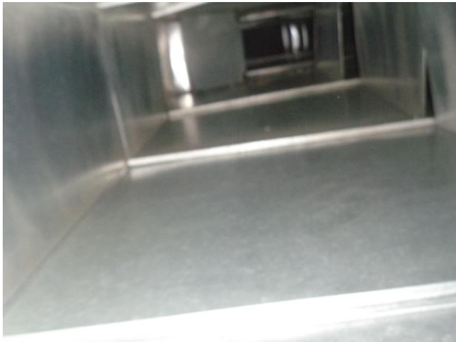
DUTO ANTES DA LIMPEZA (Foto 07)
