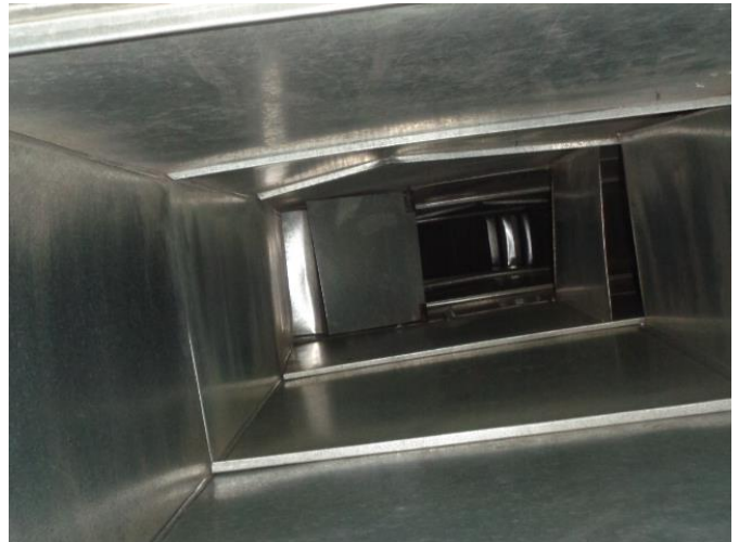
DUTO PÓS-LIMPEZA (Foto 08)
