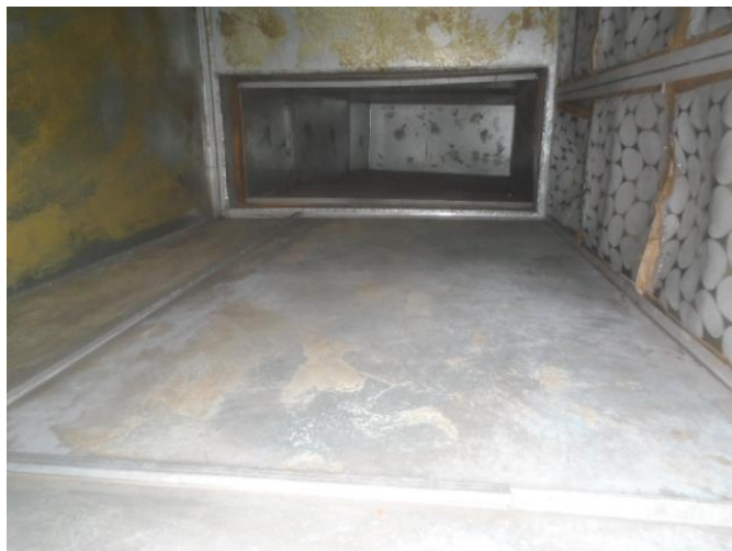
DUTO PÓS-LIMPEZA (Foto 06)
