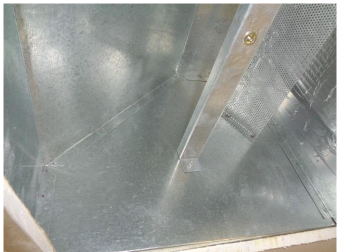
DUTO PÓS-LIMPEZA (Foto 12)
