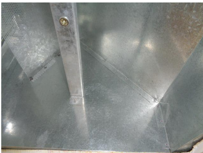
DUTO ANTES DA LIMPEZA (Foto 11)
