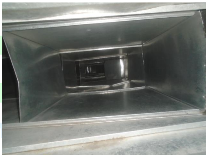
DUTO PÓS-LIMPEZA (Foto 04)
