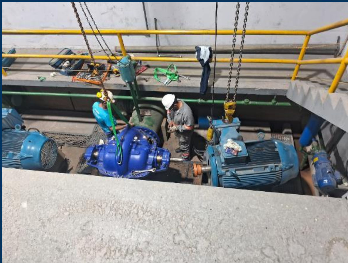
Troca da bomba 1 ECA
