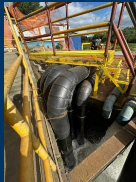
Tubos de queda de linha de recalque atuais
