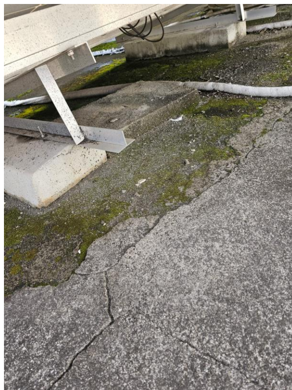
Figura 10: Suportes dos Painéis Fotovoltaicos
