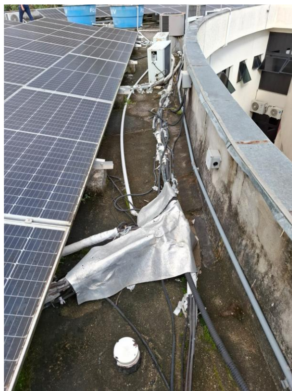
Figura 6: Painéis Fotovoltaico e do Fiações do Ar-Condicionado
