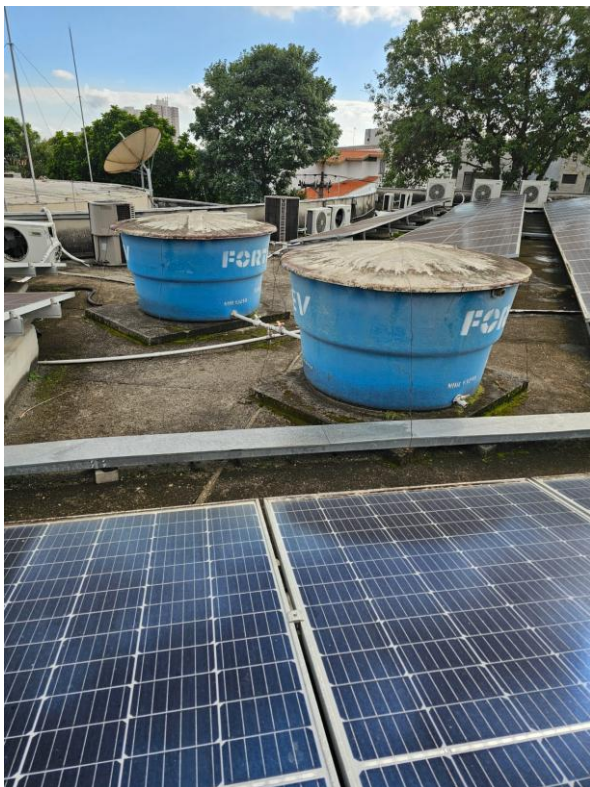
Figura 3: Caixas d'Água e Painéis Fotovoltaico
