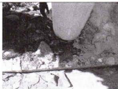
Foto 7. Raiz encostada ao poste público.
