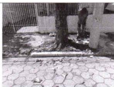
Foto 5. Danos leves no piso da calçada.
