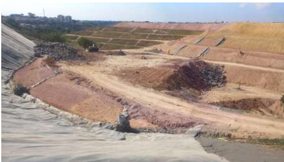
Figura 8: Vista geral do aterro com trechos sem cobertura vegetal
