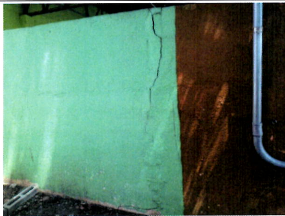
Foto 8: Patologias observadas no muro, situado na porção frontal do imóvel.
