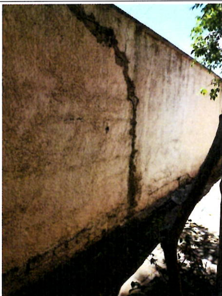
Foto 9: Patologias observadas no muro, situado na porção frontal do imóvel.
