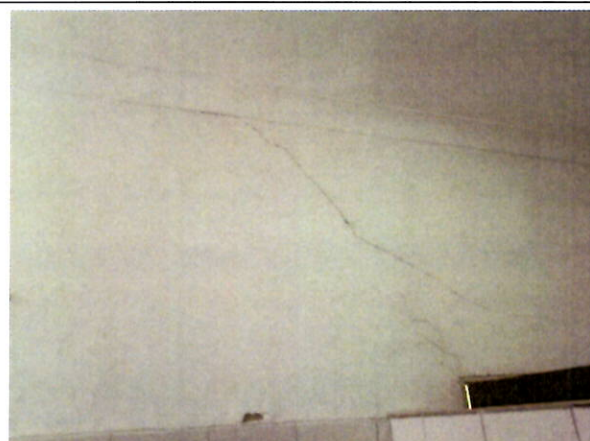
Foto 12: Fissuras observadas no banheiro feminino no pavimento térreo.
