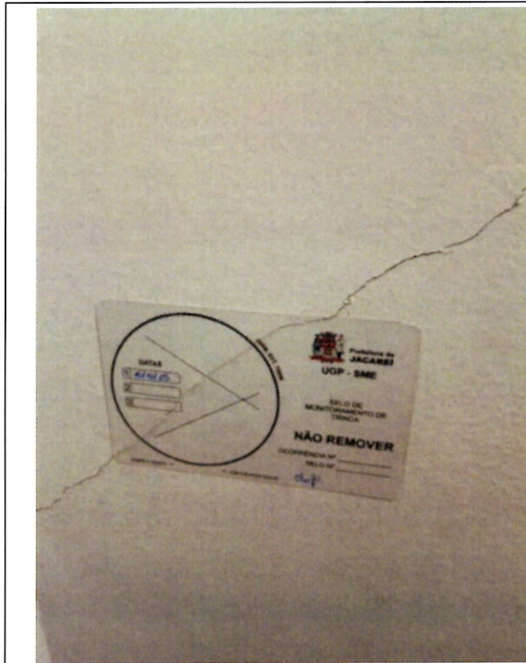
Foto 27: Detalhe das trincas que já foram marcadas para monitoramento anteriormente.
