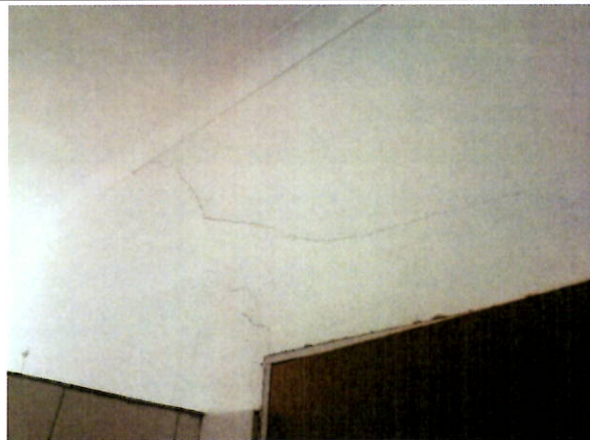
Foto 14: Fissuras observadas no banheiro feminino no pavimento térreo.
