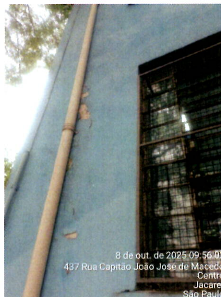
Foto 06: Mesma parede, com outras rachaduras e trincas.
