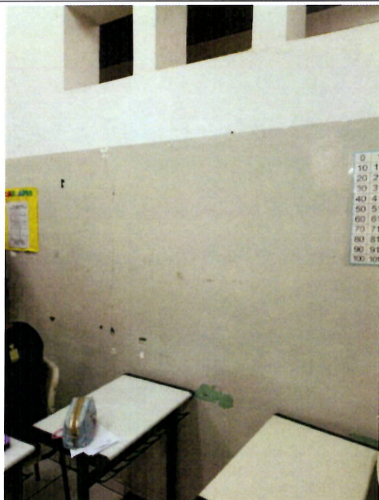
Foto 19: Fissuras observadas em sala de aula situada noo segundo pavimento.
