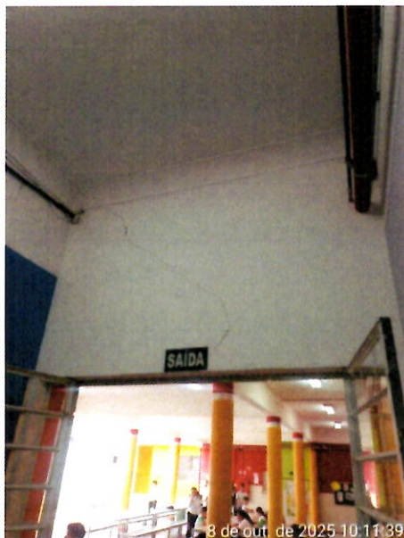
Foto 21: Saída do interior do prédio para o pátio de recreação, sobre o batente da porta, a rachadura é percebida nas faces internas e externas da parede.
