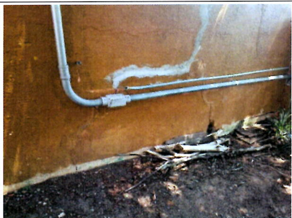
Foto 7: Patologias observadas no muro, situado na porção frontal do imóvel.
