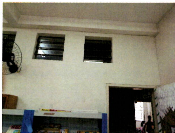
Foto 21: Fissuras observadas em sala de aula situada noo segundo pavimento.
