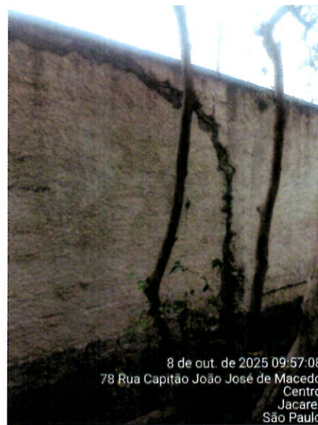
Foto 08: O muro de divisa com a Rua Lamartine Delamare possui algumas rachaduras e trincas, sendo que em alguns pontos foram reparados e voltaram a apresentar outras rachaduras e trincas.
