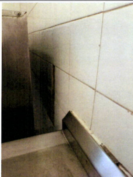
Foto 25: Azulejo que soltou atrás do forno na cozinha.
