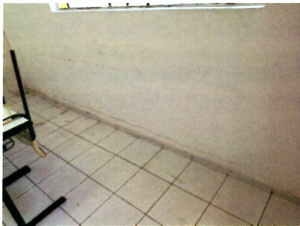
Foto 23: Fissuras observadas em sala no pavimento térreo.
