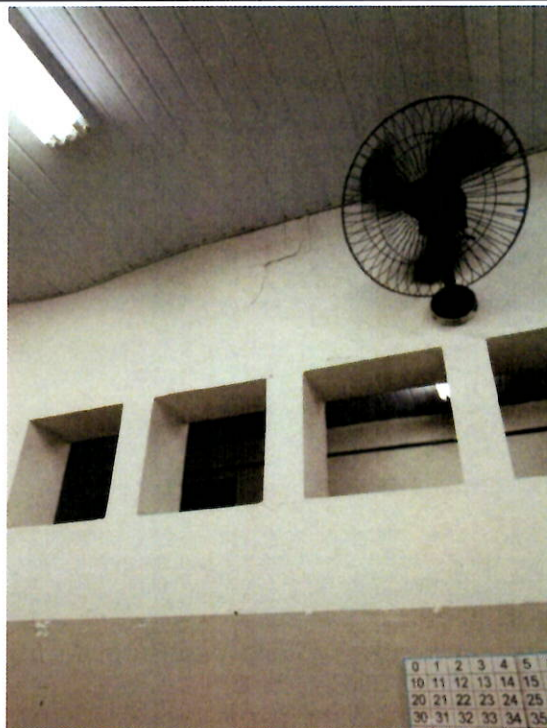
Foto 20: Fissuras observadas em sala de aula situada noo segundo pavimento.
