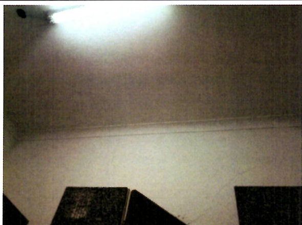
Foto 13: Fissuras observadas no banheiro feminino no pavimento térreo.
