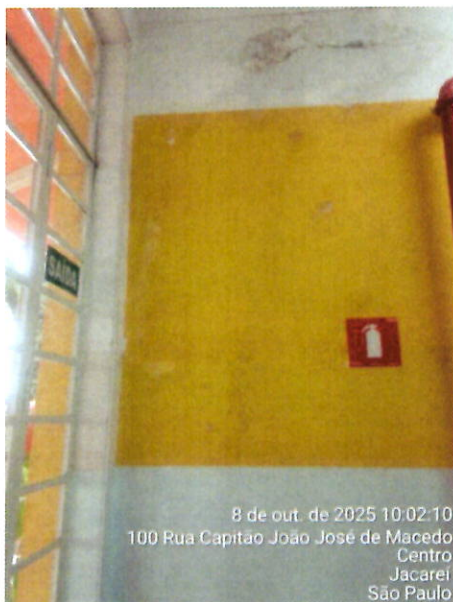
Foto 15: Hall principal de acesso ao prédio escolar, parede com trinca e umidade.
