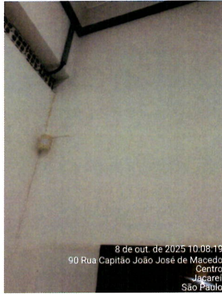
Foto 20: Outras patologias, porém, pelas mesmas causas, em outras salas do prédio escolar.
