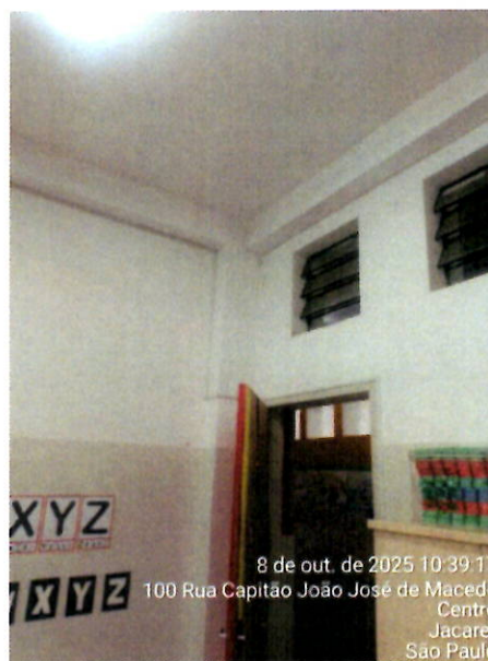
Foto 24: Salas de aulas, salas administrativas, na totalidade, sempre apresentam patologias.
