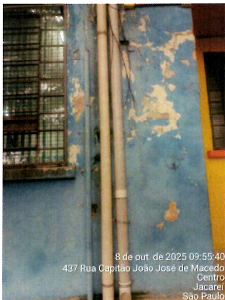
Foto 05: Além das rachaduras e trincas, também o registro da umidade nas paredes.
