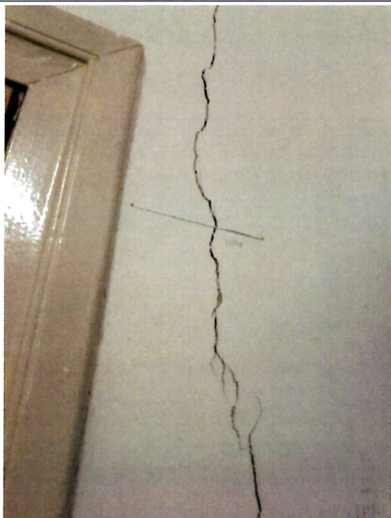
Foto 17: Detalhe das trincas que já foram marcadas para monitoramento anteriormente.
