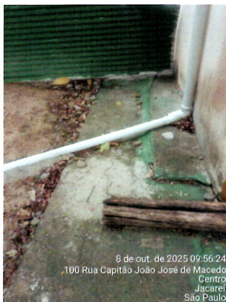
Foto 07: A calçada no entorno do prédio está desnivelada e com sinais de afundamento do solo.
