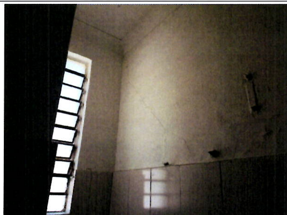
Foto 11: Fissuras observadas no banheiro feminino no pavimento térreo.
