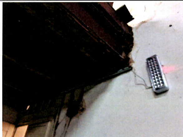
Foto 10: ponto de degração da madeira do mezanino devido a infiltração e ação de cupins
