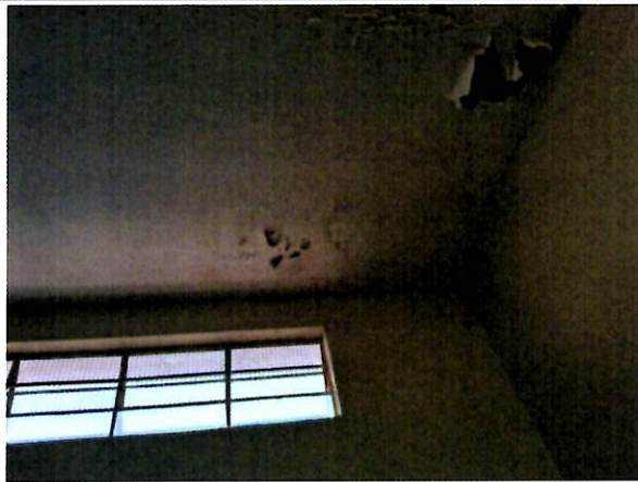
Foto 21: Infiltração sobre o sanitário do salão principal
