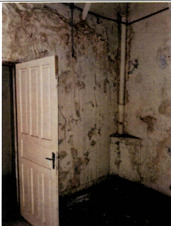
Foto 16: infiltração sobre a área do palco
