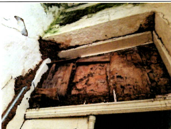
Foto 15: Infiltração na parede que dá acesso a área de palco
