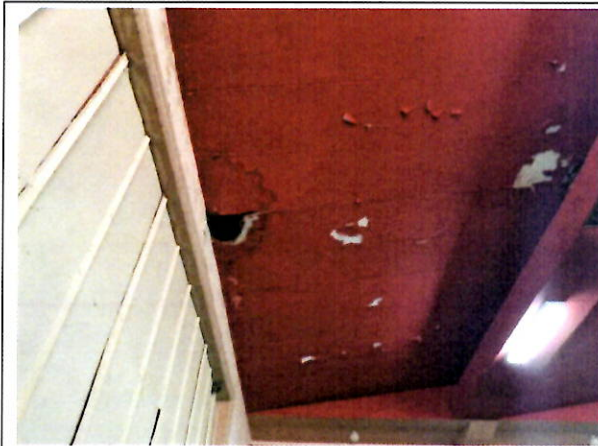
Foto 17: Infiltração sobre o forro da área utilizadas para a prática de tênis de mesa
