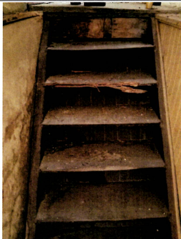
Foto 14: Degradação da escada feita de madeira que dá acesso ao palco
