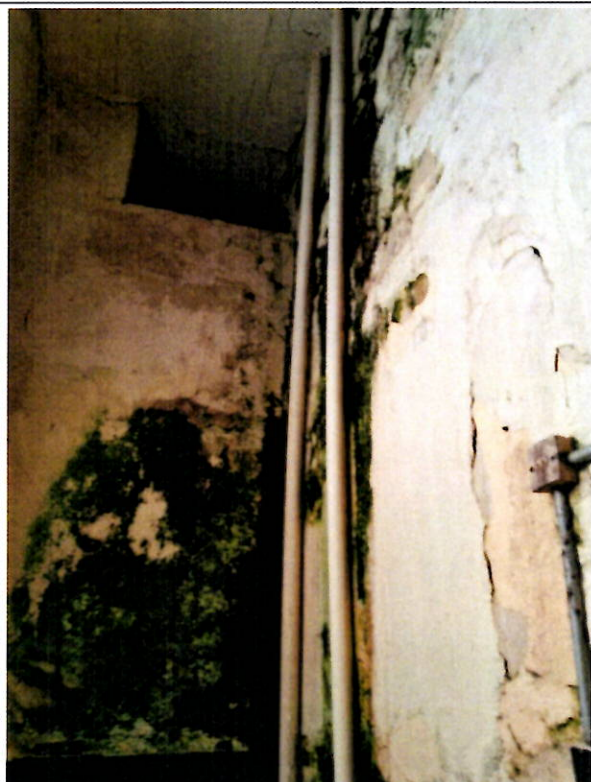
Foto 13: Infiltração na parede de acesso ao antigo Palco
