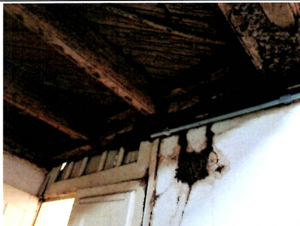
Foto 12: Degradação da madeira devido a ação de infiltração e cupins
