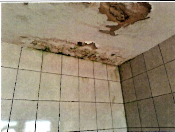
Foto 23: Infiltração sobre a laje do sanitário no salão principal
