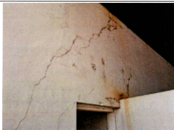
Foto 25: trinca sobre a porta de acesso ao sanitário do salão principal
