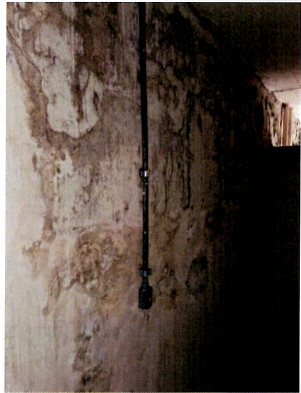
Foto 18: Infiltração sobre a área de acesso ao palco.
