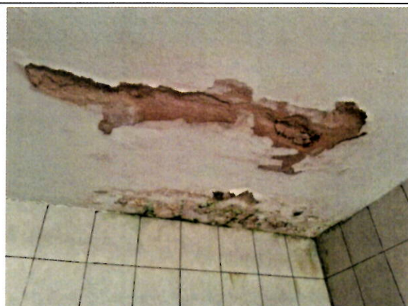
Foto 26: infiltração sobre a laje do sanitário do salão principal.
