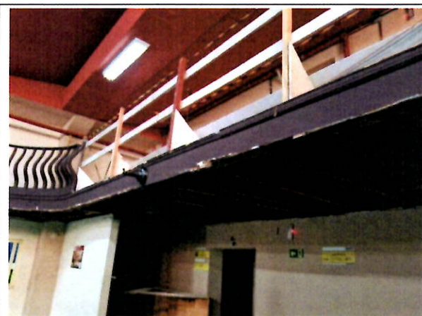
Foto 199: Colapso do guarda corpo do mezanino
