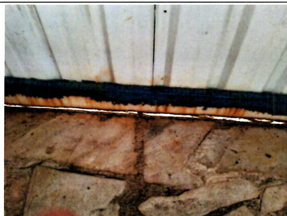
Foto 7: oxidação da estrutura
