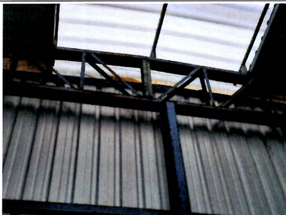
Foto 4: Oxidação das treliças de apoio da cobertura
