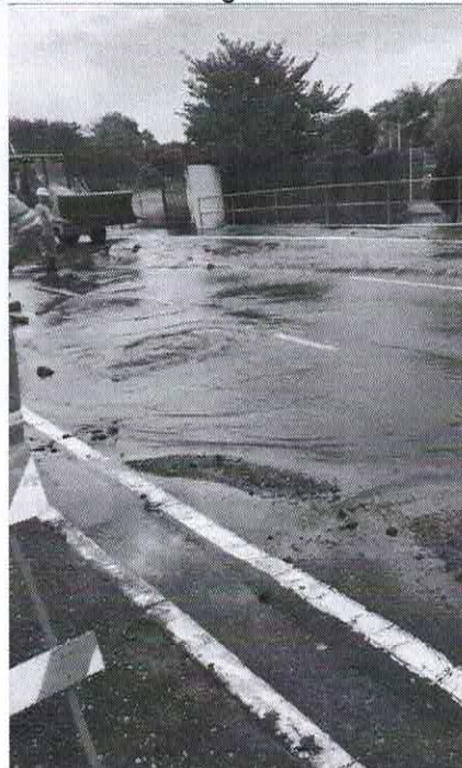
Figura 4: Volume do vazamento de água no dia 27/04/2026 às 10:19
