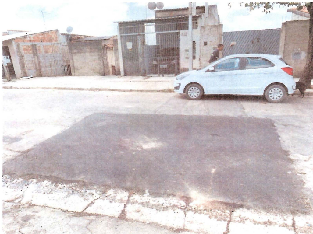
Imagem 01 – Vista da frente da residência localizada na Rua das Camélias, 233 – Pq. Santo Antônio, em relação a recomposição asfáltica.
