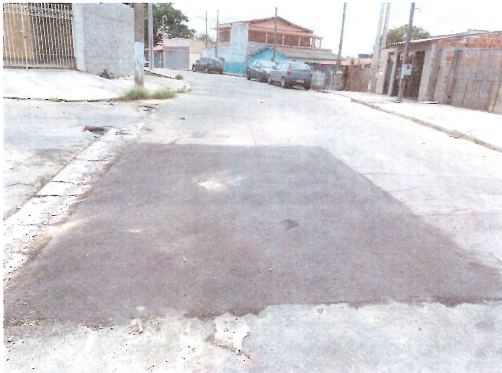
Imagem 02 – Recomposição asfáltica no cruzamento da R das Camélias com a Rua das Acácias – Pq. Santo Antônio, vista por outro ângulo.
