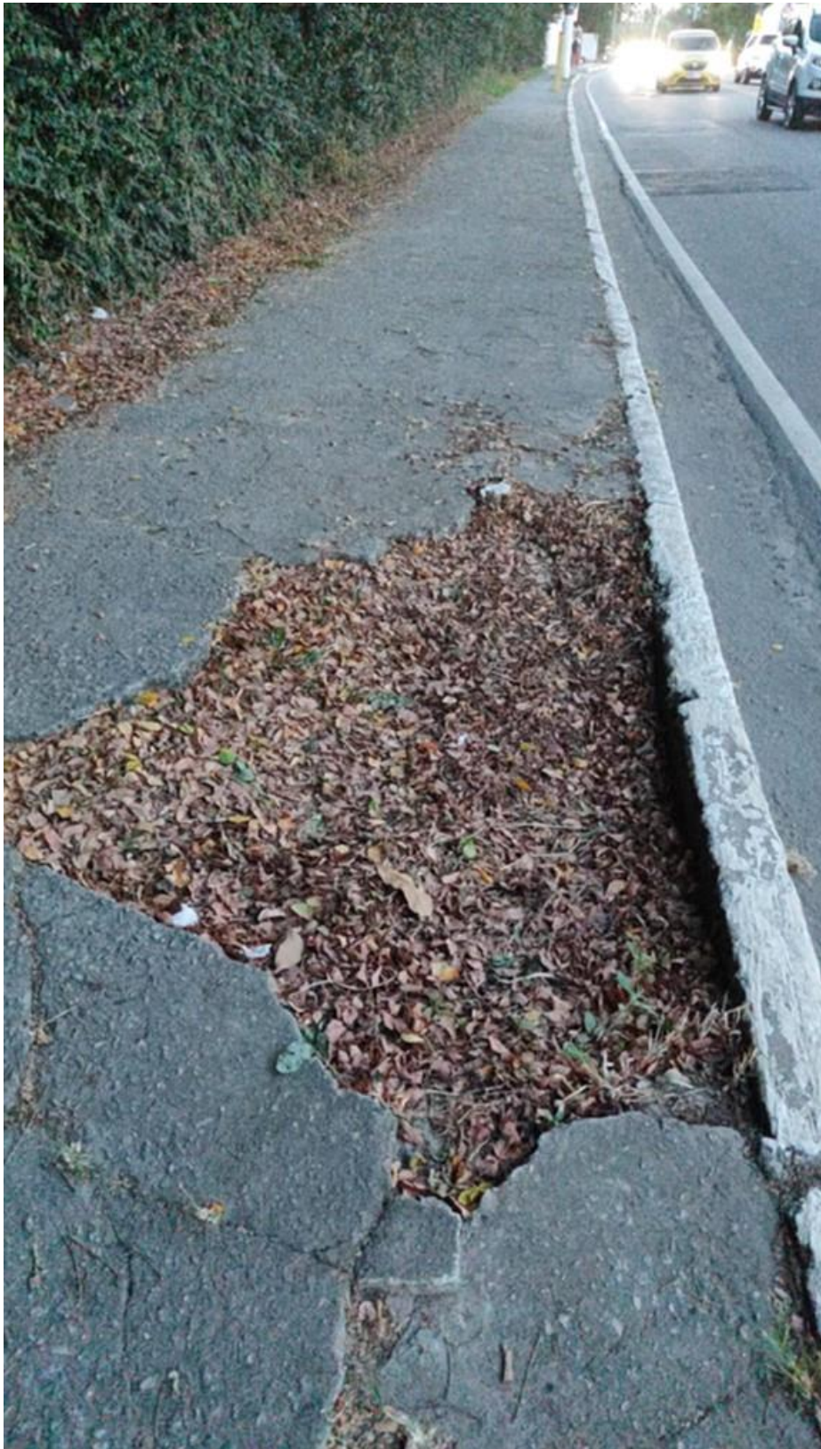
Foto 3: Avenida Nove de Julho, próximo ao nº 745, no Jardim Pereira do Amparo
