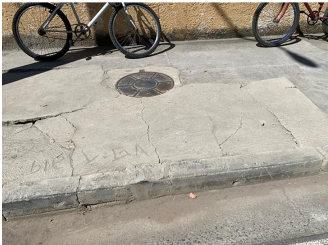
Fotos 1 e 2: Avenida Alcides Arnaldo Taino, em frente ao nº 1240, no Parque Meia Lua
